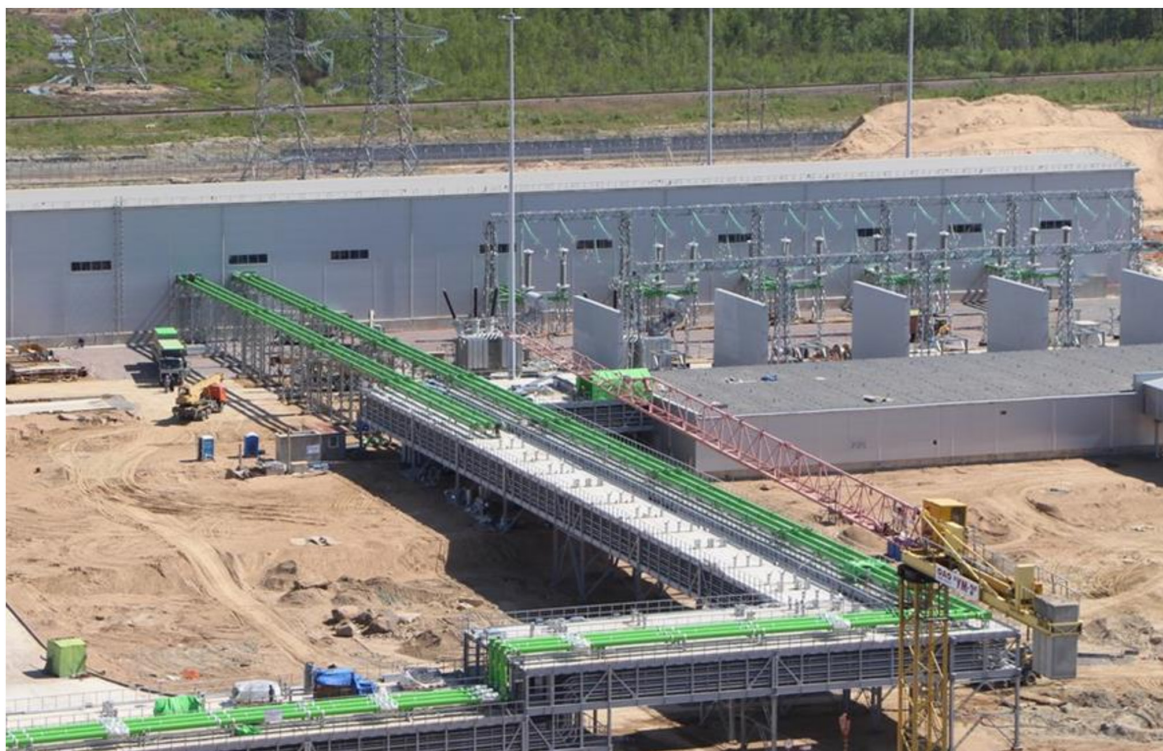
Рис. 7. Участок токопроводов ГИЛ на напряжение 330 кВ, используемых на ЛАЭС.
